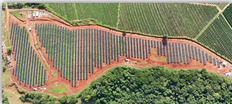
Obras UFV São Bento Abade.
