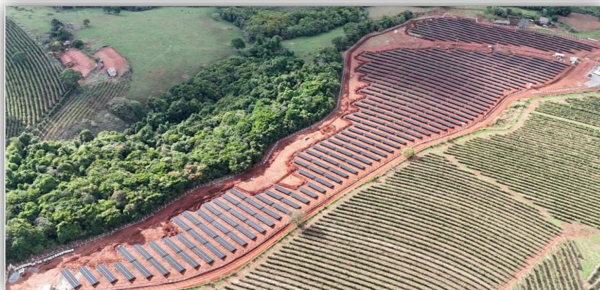
Obras UFV São Bento Abade.
